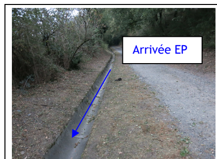
Photographie 5 : Goulotte bétonnée amenant les eaux de ruissellement du lotissement au ruisseau des Planches
