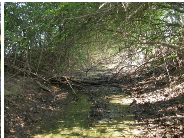
Encombrement du fossé aval, avril 2007
