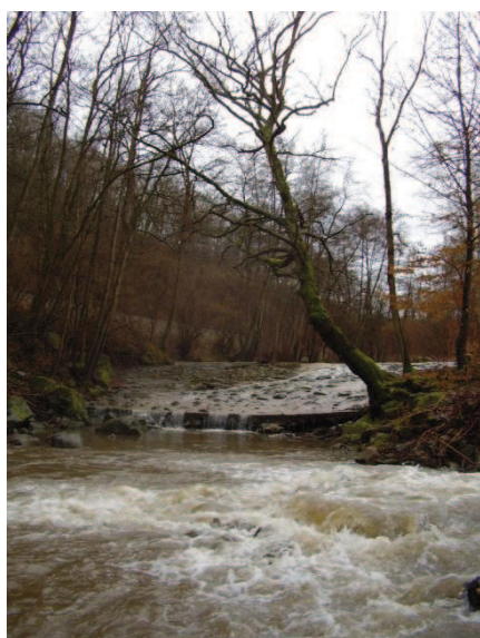
Vue aval de l'ouvrage après son contournement par la crue de Novembre 2008
