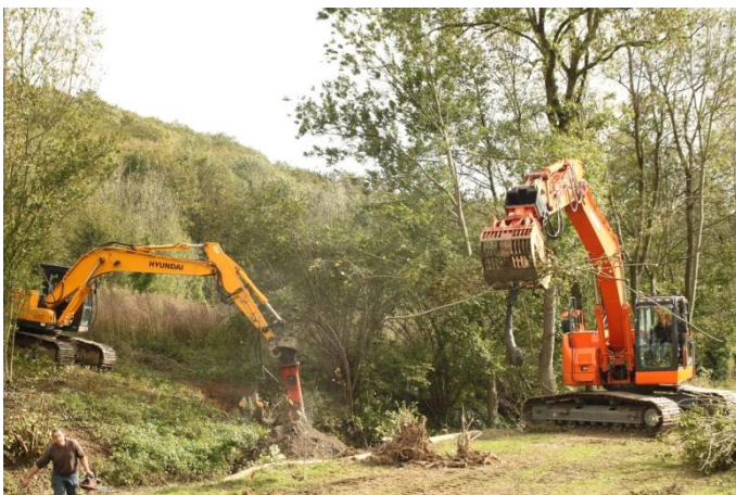
Destruction du seuil aval
