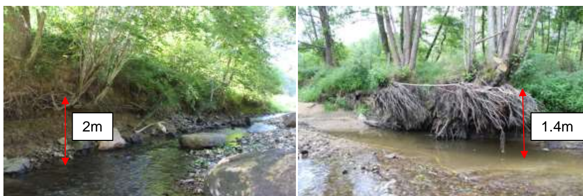
Figure 26 : Signes d'enfoncement du lit en rive droite sur la Coise à Choules à gauche et à Rivat à droite (9/08/2016)
