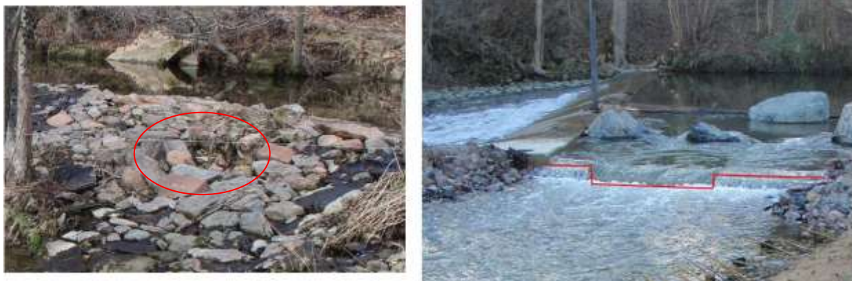
Figure 28: Illustration des zones de parement à reprendre (13/02/2017) et d'un exemple d'aménagement de la crête d'un seuil et de l'entrée d'une rivière de contournement (Seuil de Sain Bel – travaux SYRIBT)
